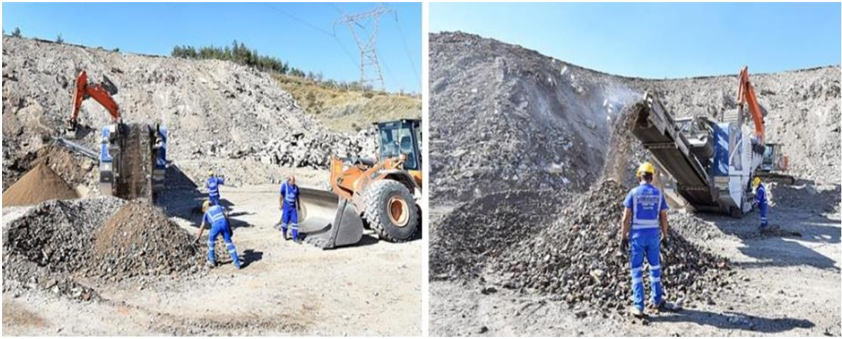
4. 3. ábra İZBETON újrahasznosító létesítmény (İzmir Városi Önkormányzat, 2021).
